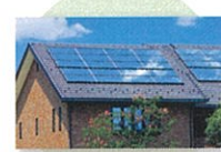
太陽光発電システム
